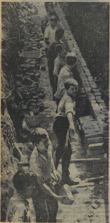
Такие бывают, когда дом становится тесным. Ребята 24-й школы города Полтавы мечтали о новом корпусе. Летом в школу пришли строители. И ребята вместе со взрослыми строят 12 новых кабинетов и мастерские. Работает живой конвейер.
